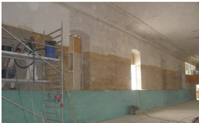
Betonpuds er her blevet hugget ned.
